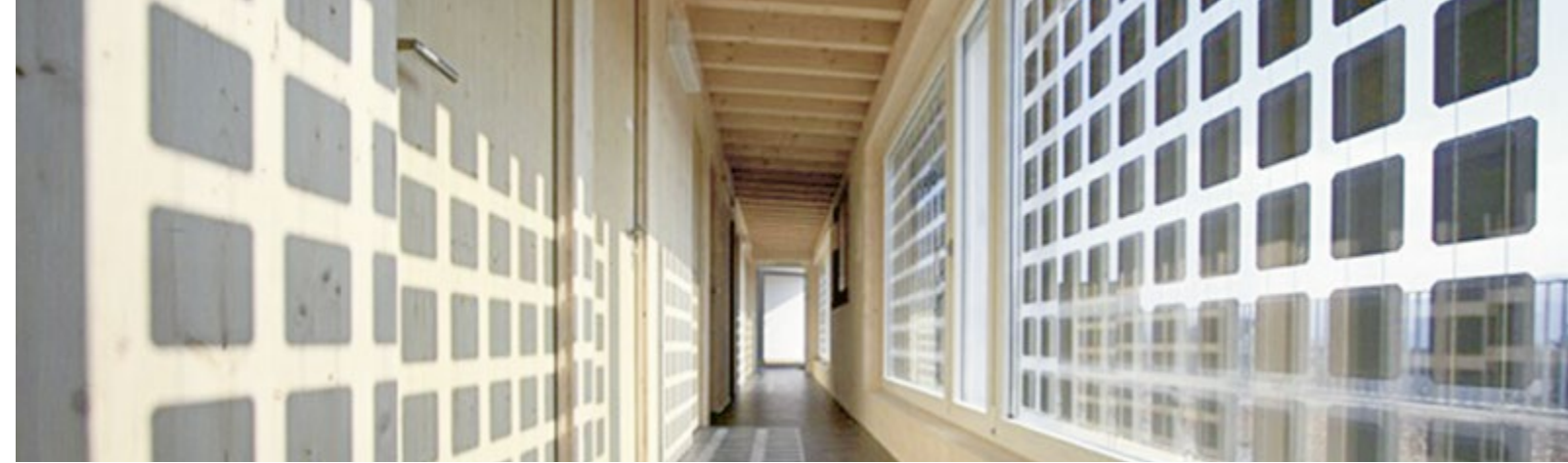
Photo : modules PV en façade dans le cadre d'une rénovation Minergie-P d'un immeuble à Wettingen | © Miloni Solar AG, Wettingen
